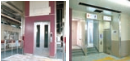
ホーム上からコンコースへ 連絡するエレベーター (くぬぎ山駅)
