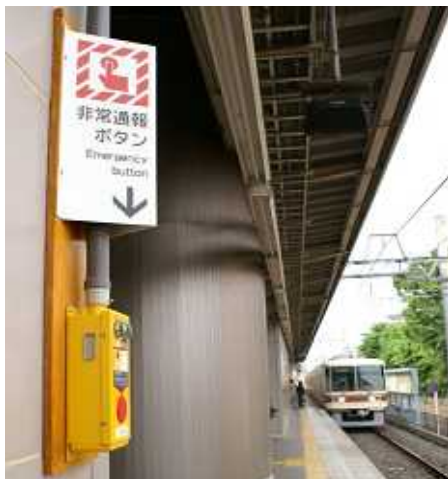
非常通報装置
