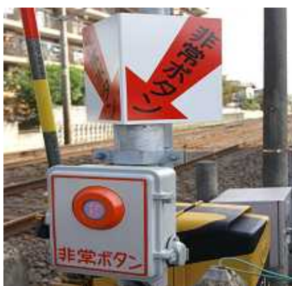
踏切支障報知装置
