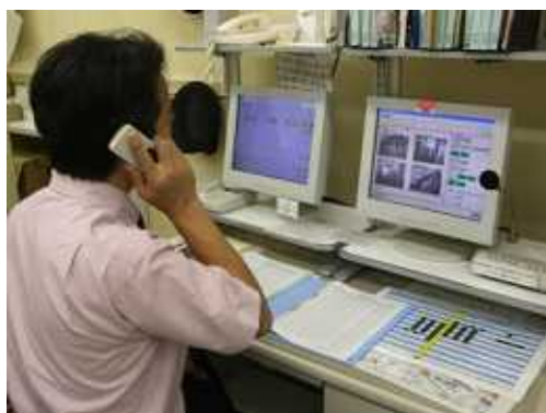
松戸駅及び新津田沼駅に設置された監視設備
