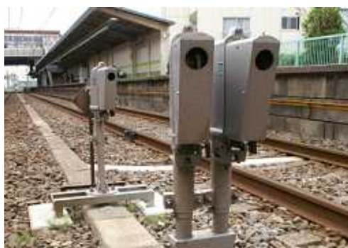
踏切障害物検知装置
