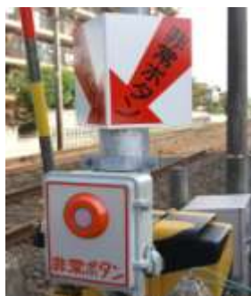
踏切支障報知装置
