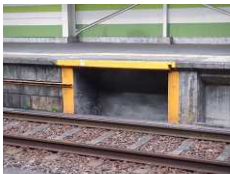
ホーム下の待避スペース
