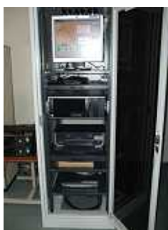
緊急地震速報受信装置
