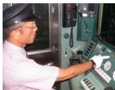
運転士異常時列車停止装置
