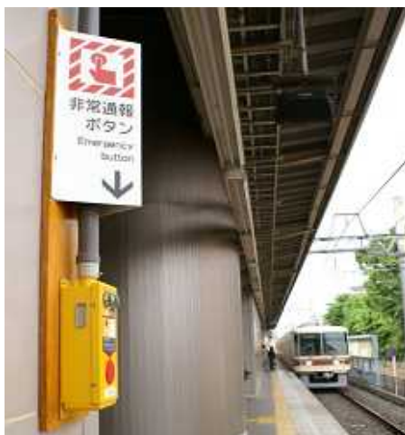
非常通報装置
