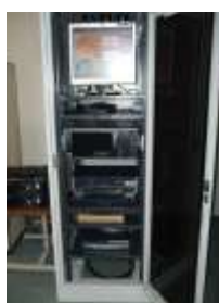
緊急地震速報受信装置
