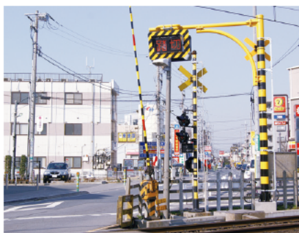
視認性のよい大型踏切警報機
