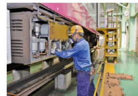
コンプレッサーの点検(月検査)
