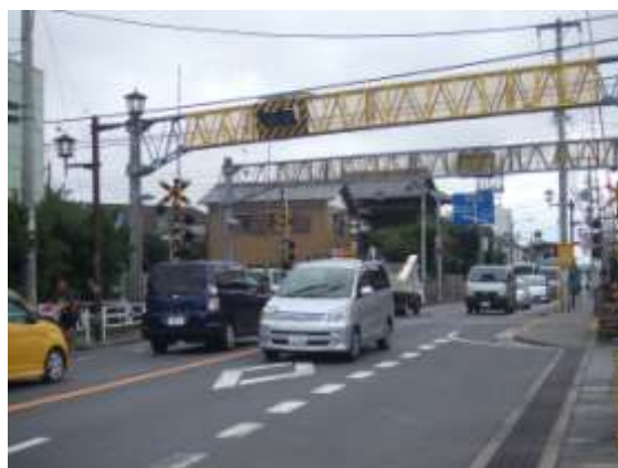
大型踏切警報機
