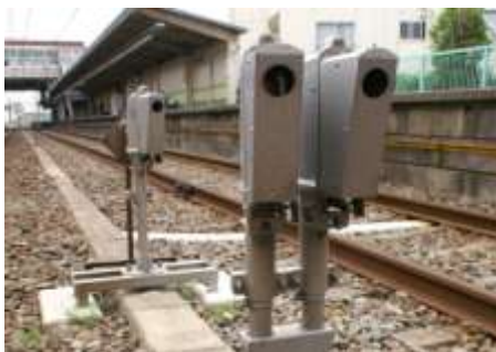
踏切障害物検知装置
