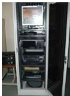
緊急地震速報受信装置
