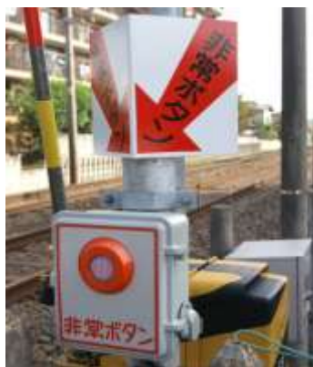
踏切支障報知装置
