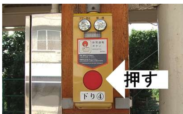
非常通報装置 赤いボタンを押して使用します
