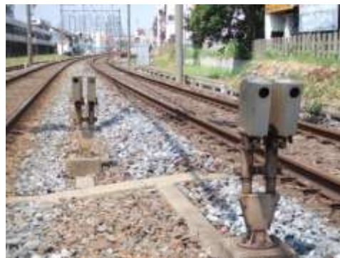
踏切障害物検知装置
