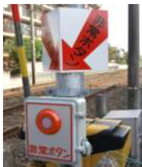
踏切支障報知装置
