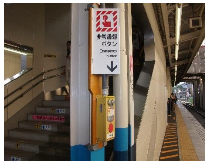
非常通報装置（赤いボタンを押して使用します）
