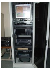
緊急地震速報受信装置
