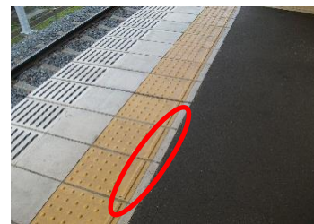
内方線付警告ブロック
