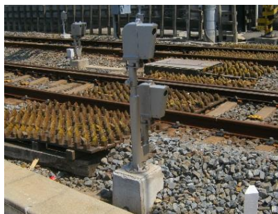
踏切障害物検知装置
