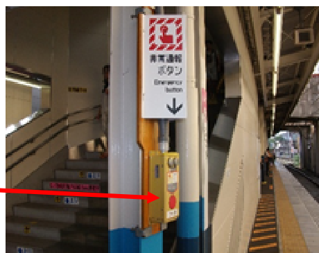
非常通報装置
