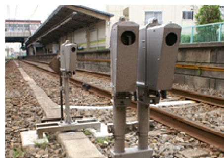
踏切障害物検知装置
