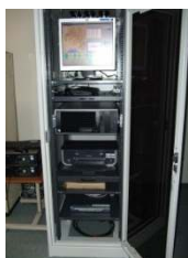
緊急地震速報受信装置
