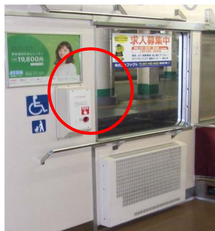
車内の通報装置
