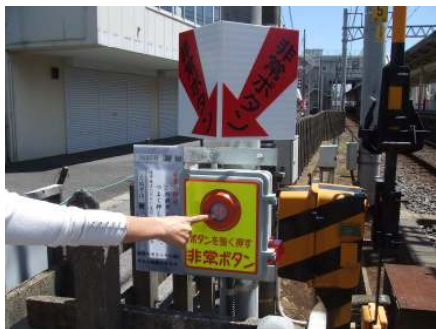
支障報知装置
